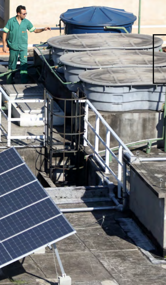
Painéis solares em prédios no centro do Rio (junho de 2023)
